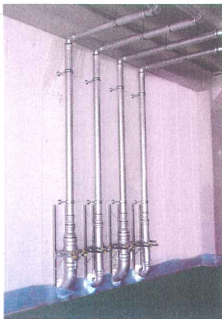
Vier nebeneinander verlaufende Fallleitungen vom Notablaufsystem, die ins Freie auslaufen
