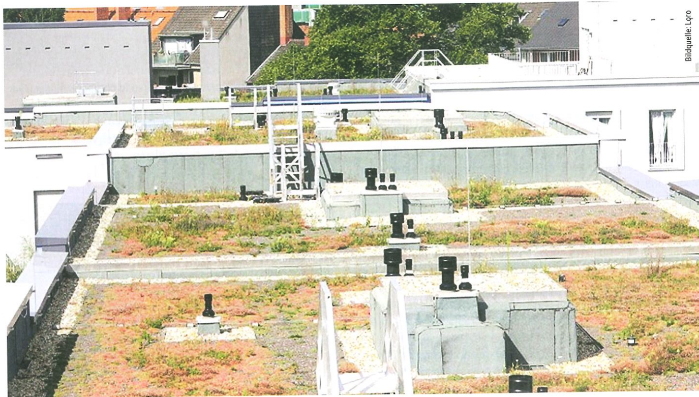
Gründach mit Retention.
