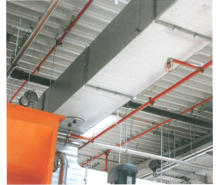
Die Entwässerung läuft unter dem Hallendach über Sammelleitungen als Druckentwässerung in schmalen Rohren (DN 70). Die roten Leitungen sind Sprinkler für den Brandschutz.
