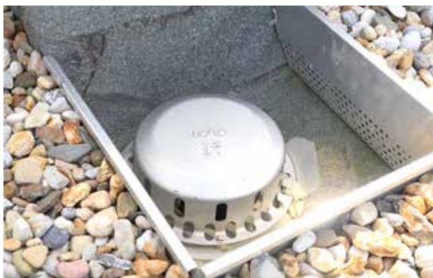
Mit Retention nachgerüster LORO-X RAINSTAR Attikaablauf
