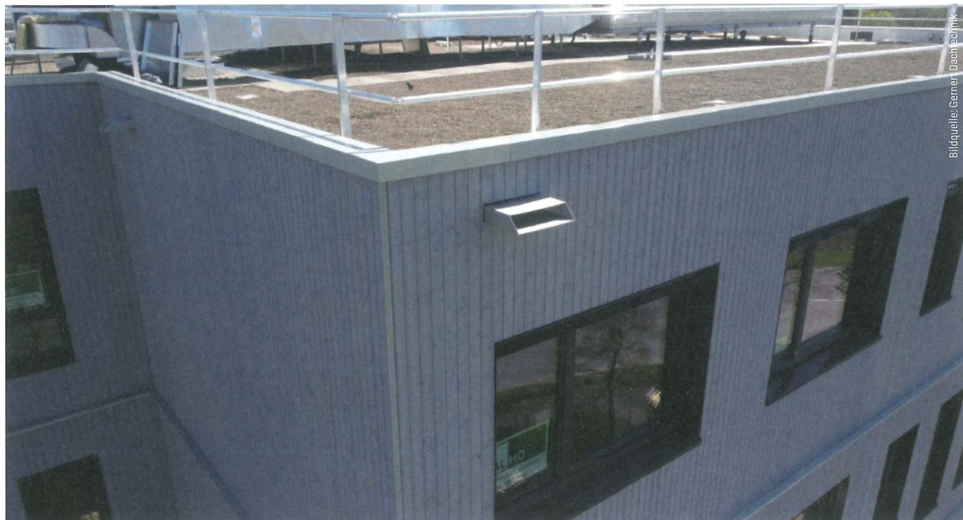
Er sieht elegant aus und ist effizient: Rechteckspeier als Notentwässerung.
